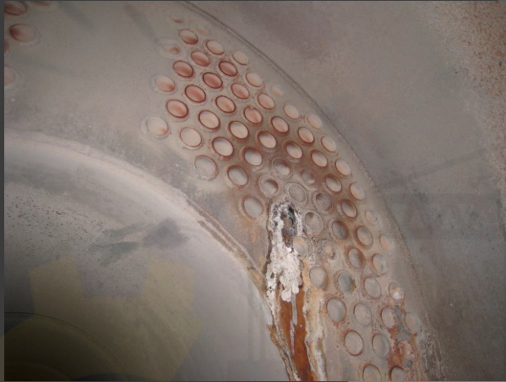
بازرسی نشتی از سر لوله ها
