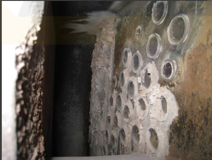
بازرسی نشتی از سر لوله ها
